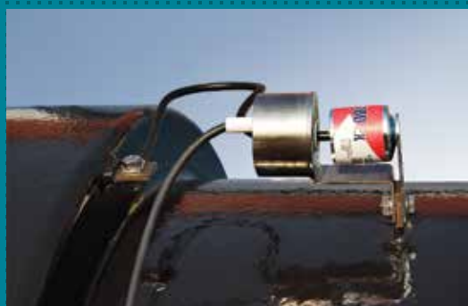
Датчик МКИ на искроразряднике
