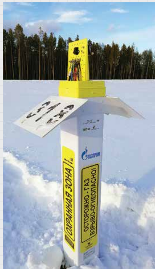
КИП на 318-ом километре газопровода Сила Сибири
